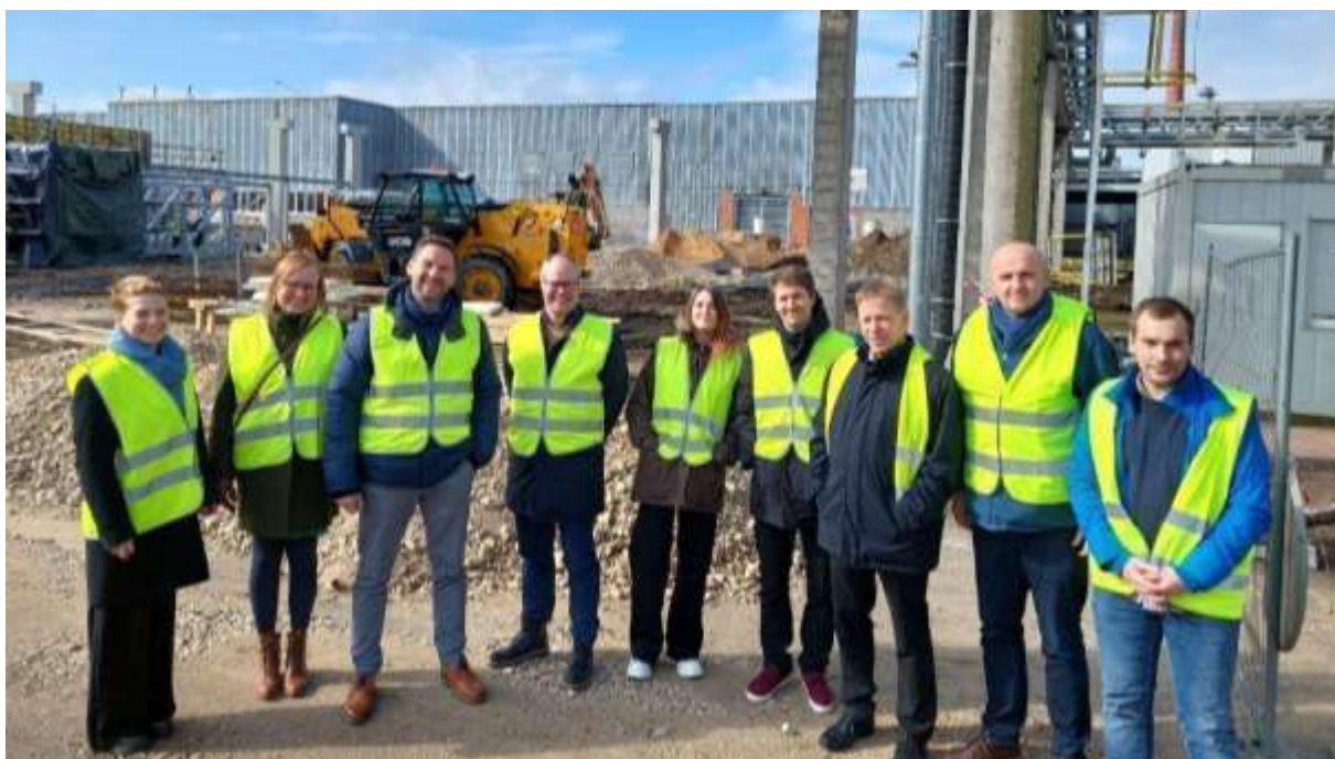
1.20. att. VIOBOND projekta dalībnieki kārtējā tikšanās reizē jaunā sveķu ceha būvēšanas vietā.
